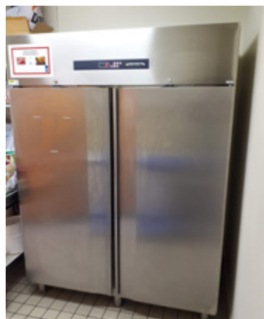
Local chambre froide du restaurant scolaire
