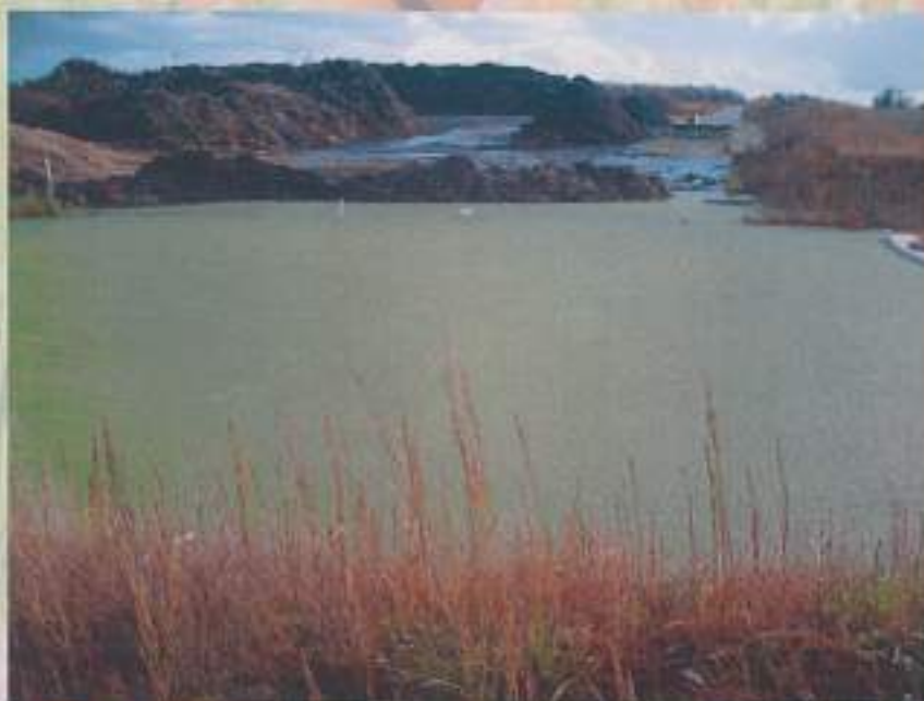
L'eau croupie verte déborde du bassin de rétention : risques de pollution des nappes phréatiques.
