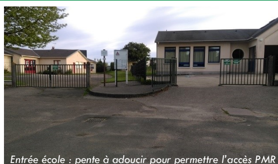
Entrée école : pente à adoucir pour permettre l'accès PMR
